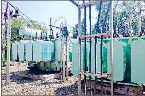
फतेहाबाद। सब स्टेशनों में लगे ट्रांसफार्मर।
